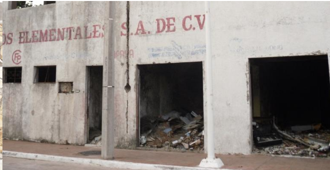
Foto 4. Edificio abandonado usado como basurero.
